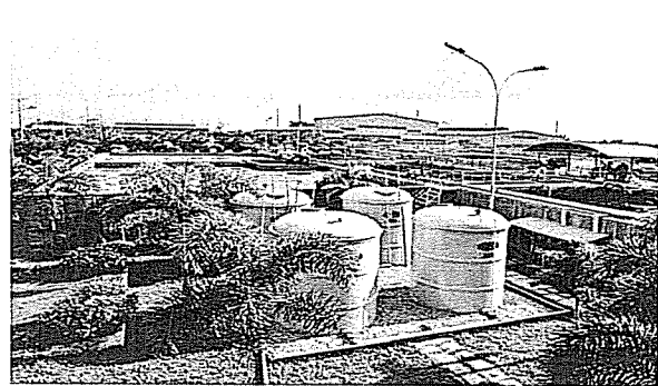
Hình 2. Trạm xử lý nước thải KCN Hiệp Phước
